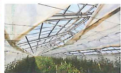
▼二重構造のビニールハウスをダクトとして活用(写真は内側開放中)。
