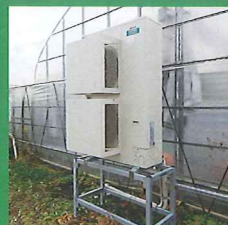
▲室外機は架台による嵩上げと防雪フードで雪対策。
