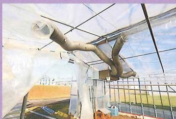
▲室内機はビニールダクト方式。
