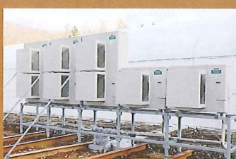
▲栽培室の他、培養室、処理室にも空調完備。
