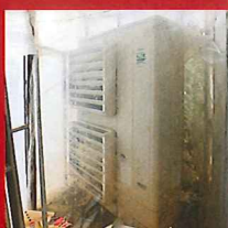
▲二重ハウス内に設置された室外機。
