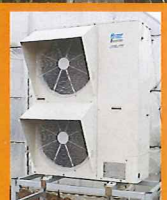
▲室外機は通常の設置方法。
