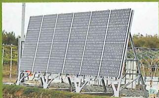
▲太陽光発電パネルはシリコン結晶素子、計4.2kW。風力は定格1kW×2台。
